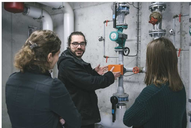
Le conseiller en énergie partagé explique le fonctionnement de la chaufferie d'un bâtiment public © David Gallard
