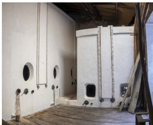
Les cuves de l'établissement de négoce de Gabriel Thébaud (c) Région Pays de la Loire - Inventaire général : PB Fourny
