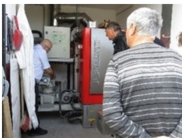
Visite chaufferie bois à La Grigonnais © Syndicat Mixte du SCoT et du Pays du Vignoble Nantais
